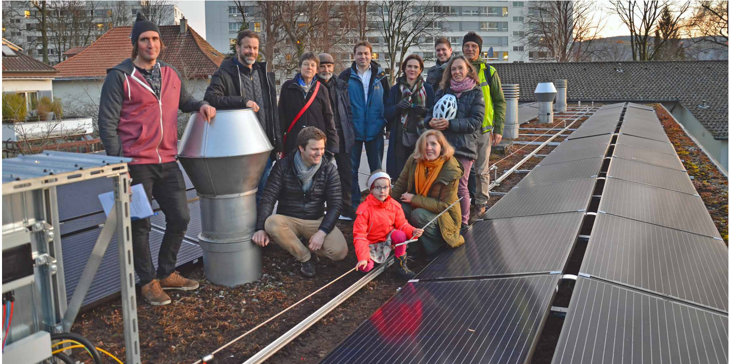
Die von Sunraising und dutzenden Panelbesitzer:innen im Jahr 2018 realisierte Solaranlage Jolimont im Berner Ostring liefert mit einer Leistung von 37 kWp den Strom für rund 60 Haushalte (H4) pro Jahr.
