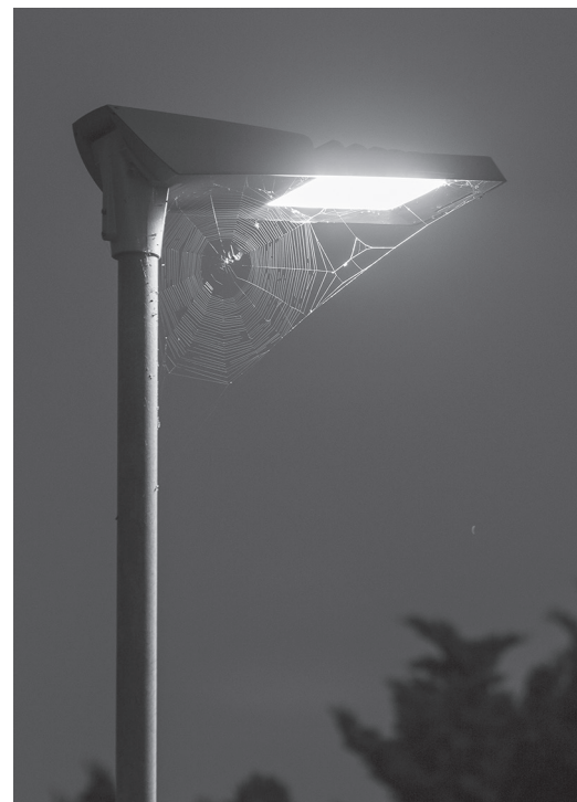
Les LED n'ont pas besoin de maintenance. Par contre, il faut les nettoyer régulièrement. © S.A.F.E.
